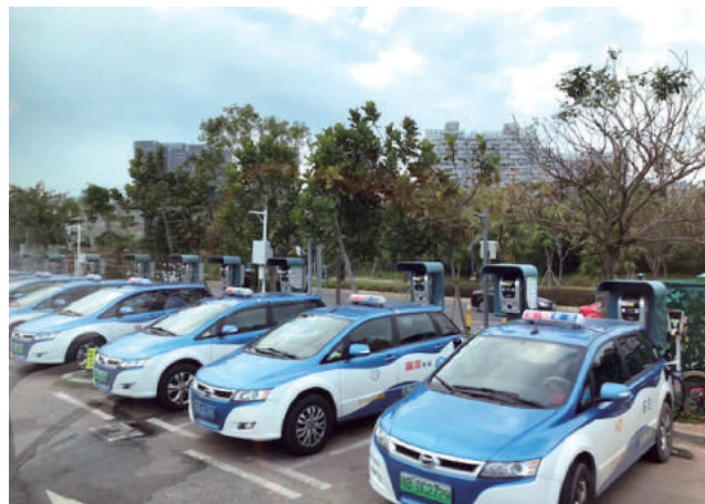
EV充電ステーション
